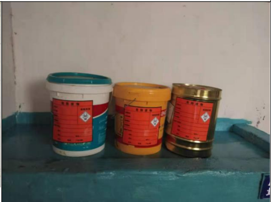
危废暂存间围堰
