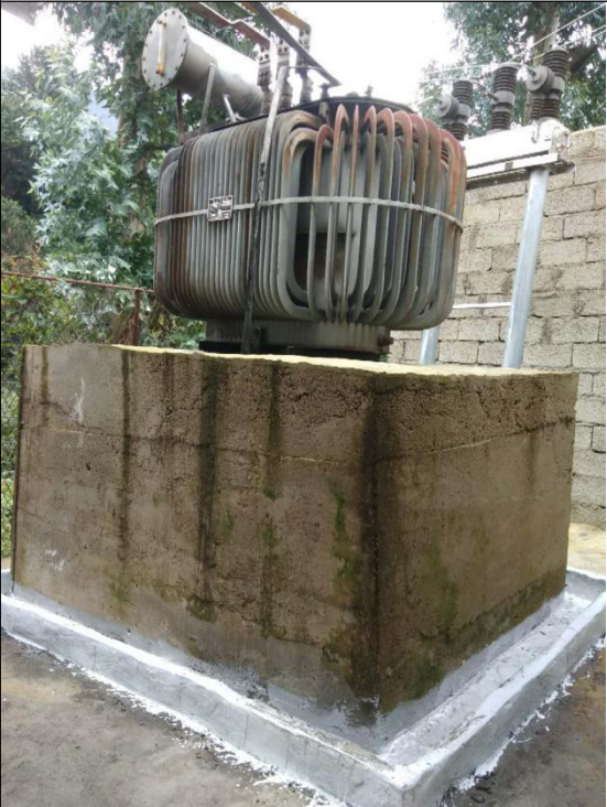
变压器站围堰
