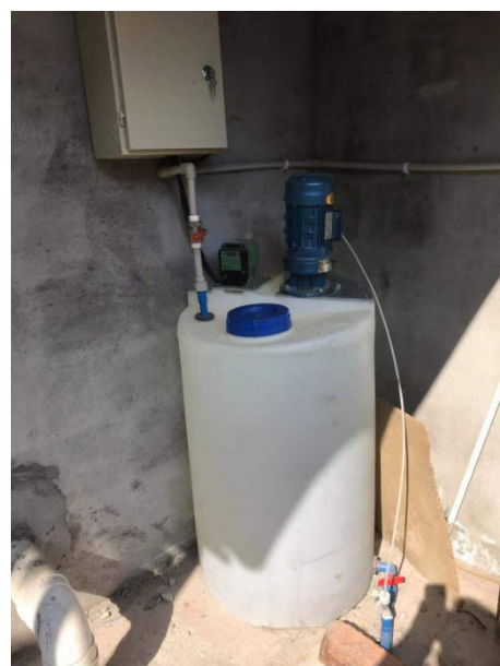
污水处理站内部
